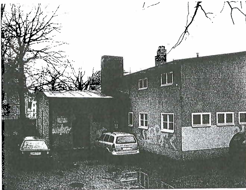
Pannskorsten och avluft för ventilation i svartplåtskorstenen.
